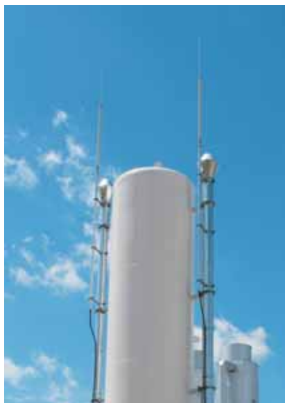
Sistema isCon® na área de saída de uma unidade de biogás
