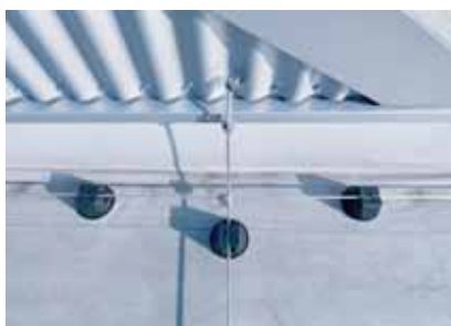
Ligação da fachada de metal ao sistema de proteção de raios
