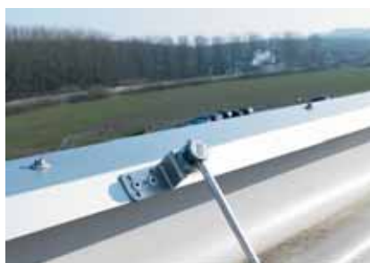
Ligação do parapeito ao sistema de proteção de raios
